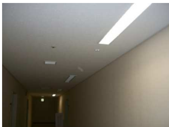
【間引き点灯の様子 病院外来棟5階】
